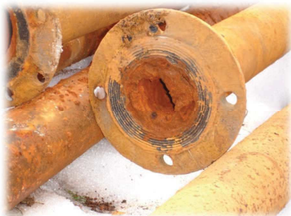
Lažany – výtlačné potrubí čerpadla – železité inkrustace
