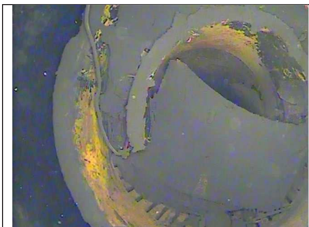
Foto 3: Deformace přechodu pažnic po pádu čerpadla (hloubka 15 m)
